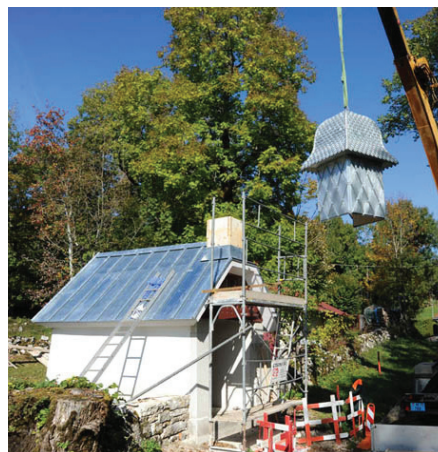
L'oratoire avant la restauration (à gauche). La pose du clocher en octobre 2011 (à droite)
